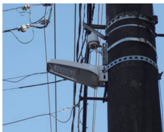
電柱に設置されたLED街灯
